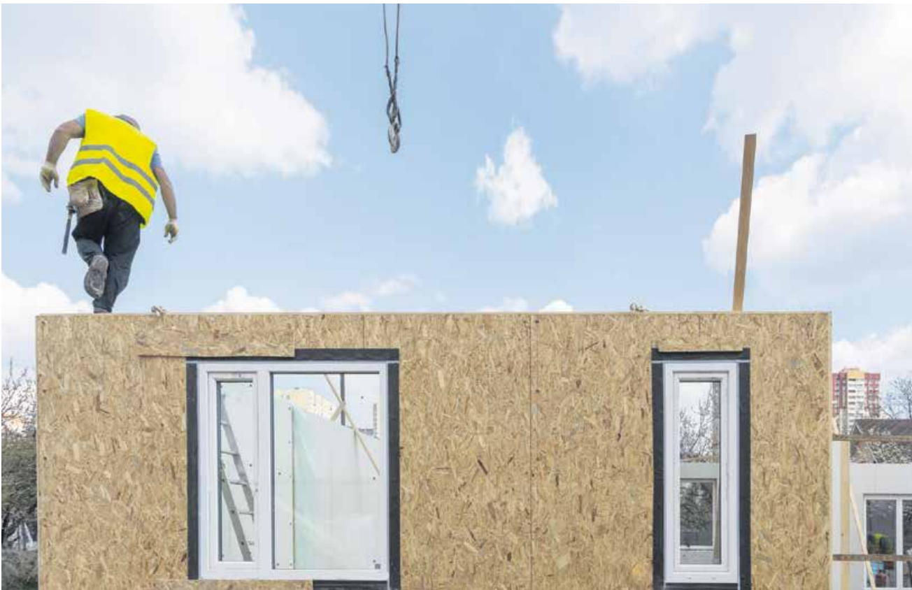
Gerade bei Arbeiten in niedrigen Höhen – zwischen zwei und drei Metern – ist das Risiko für einen Absturz hoch.
